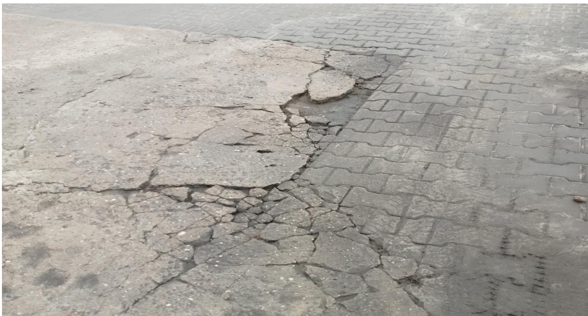
Ryc. 23. Przykład ciągów komunikacyjnych na terenie kompleksu basenowego w złym stanie technicznym
